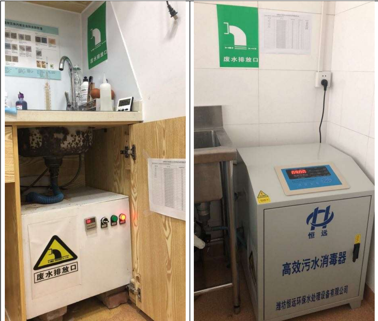
污水处理设施照片
